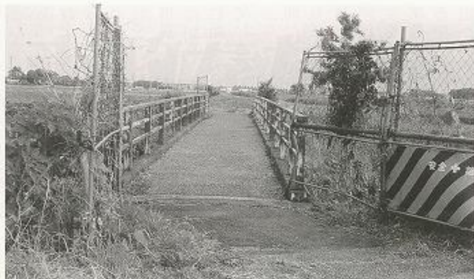
老朽化の著しい角田橋
