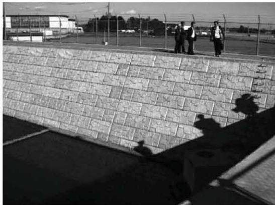
▲仁良川調整池の水はけが悪い排水溝
