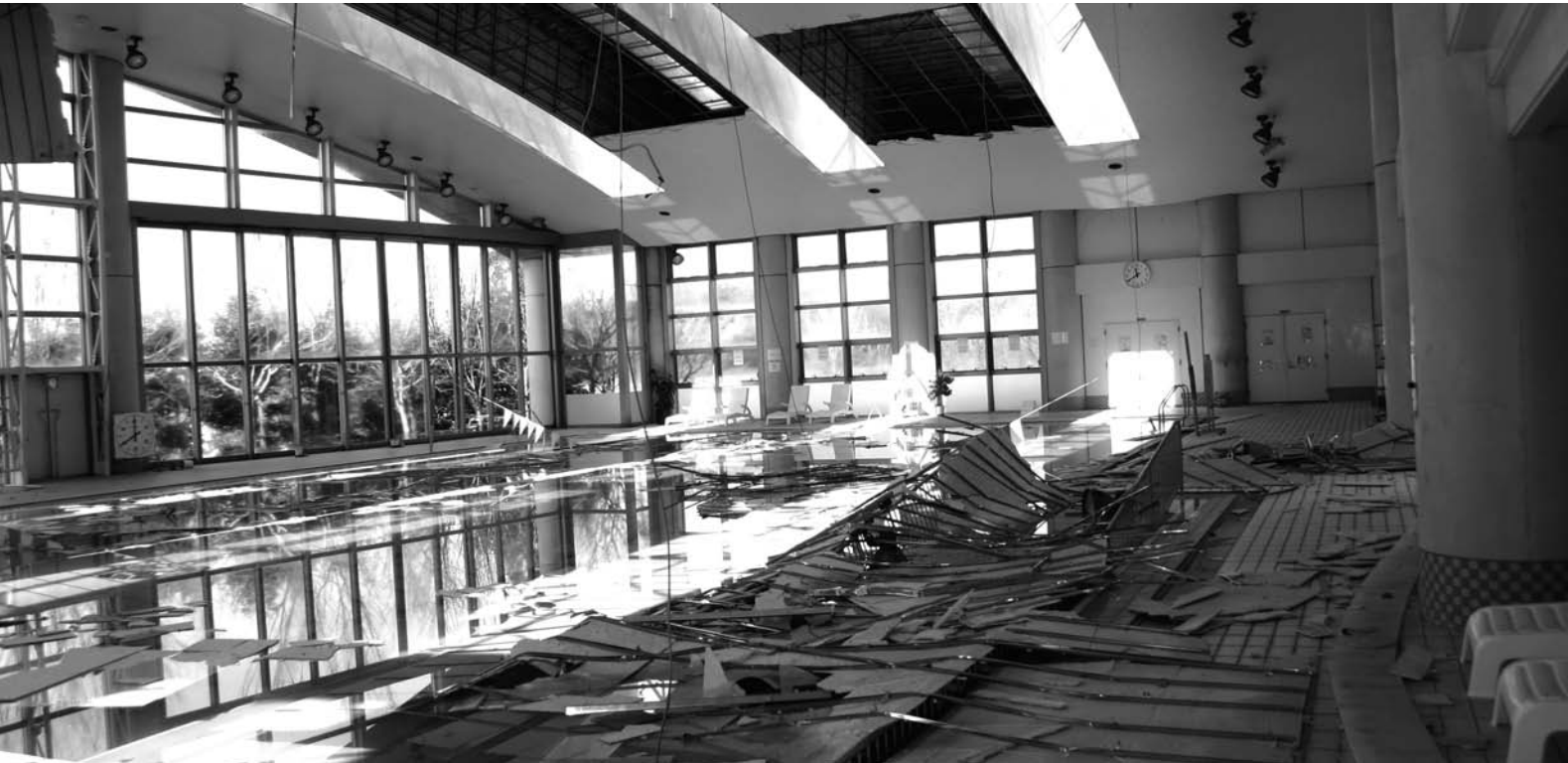
震災により天井が崩落したふれあい館プール
