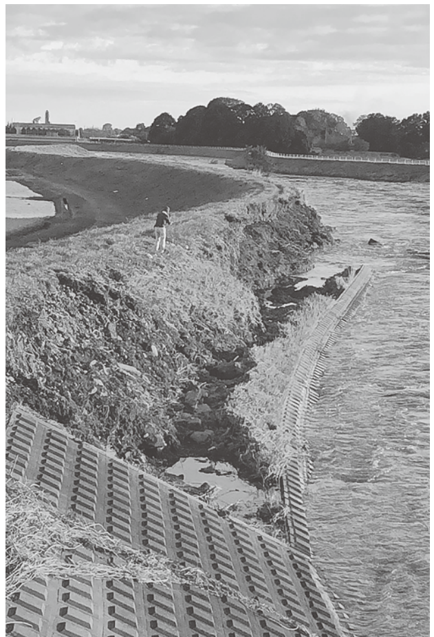
堤防が崩壊した田川左岸
