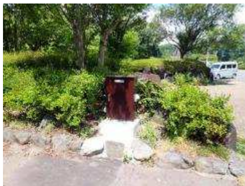
■園路沿いに整備された電源装置
