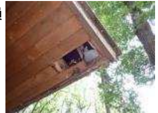
■トイレ屋根の破損
