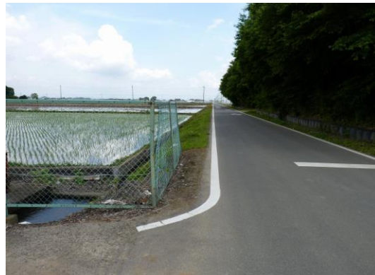
用水路転落防止の金網柵。
