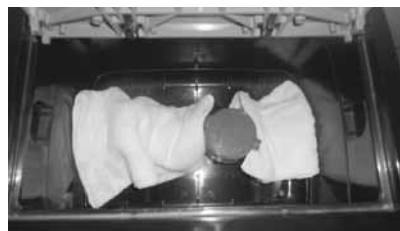
(例)メーターボックス内の保温対策
